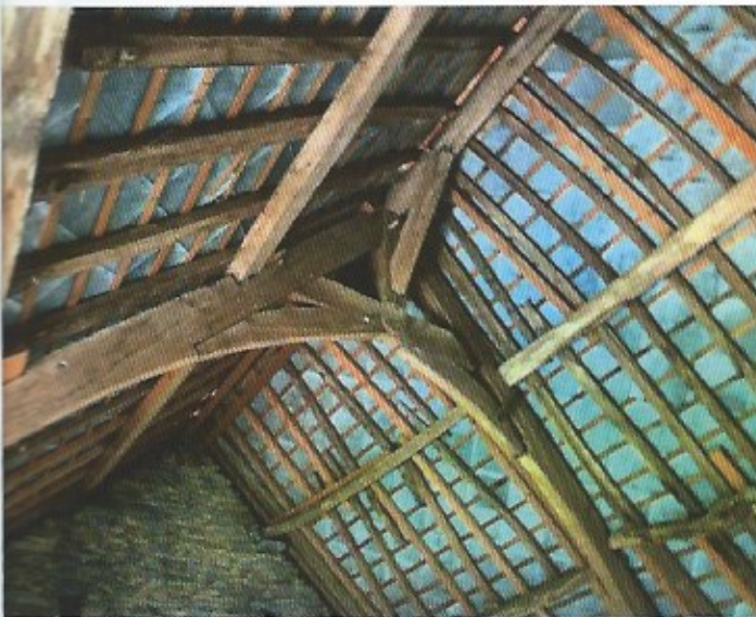
En haut : la ferme de charpente de l'aile arrière, elle aussi datée de la fin du XV e siècle.
